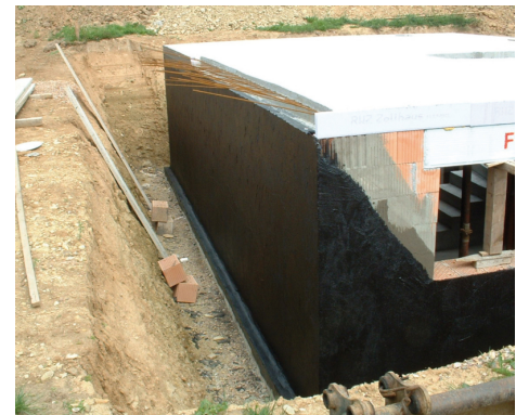
Uszczelnienie zewnętrznej ściany piwnicy z betonu przy zastosowaniu PCI Pecimor ® 2K. Wygodna obróbka dzięki wypełnieniu polistyrenowemu.
